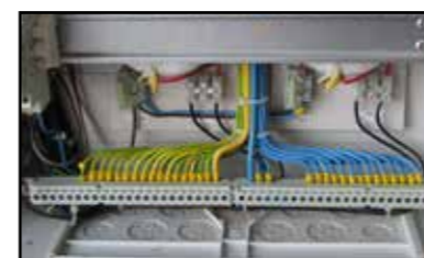
Dostatek prostoru pro kabeláž
